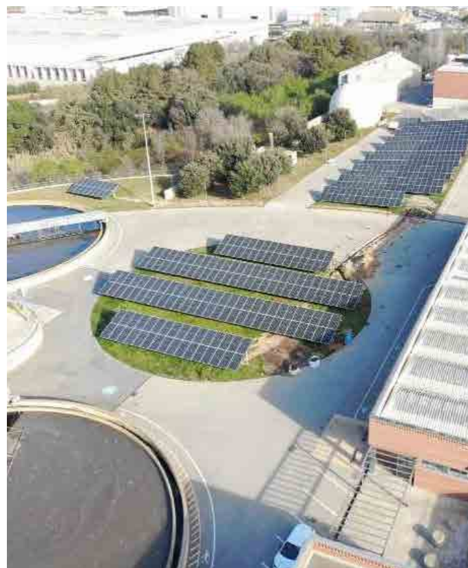
Nou parc fotovoltaic a l'EDAR de Sabadell Riu Ripoll.
