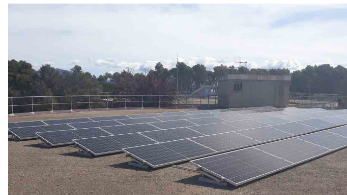
Noves cobertes solars al dipòsit de Ca n'Ustrell.
