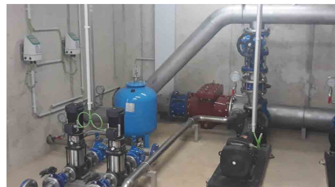
Noves instal·lacions de bombament d'Aigües Sabadell a Bellaterra.
